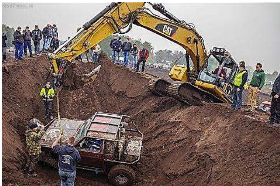
Gambar 6.21 Pengoperasian Excavator pada Area Berbahaya
